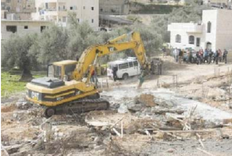
Buldozers fabricados en EEUU utilizados por las fuerzas Israelíes para demoler casas Palestinas.
